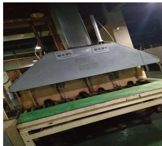
废气收集装置
